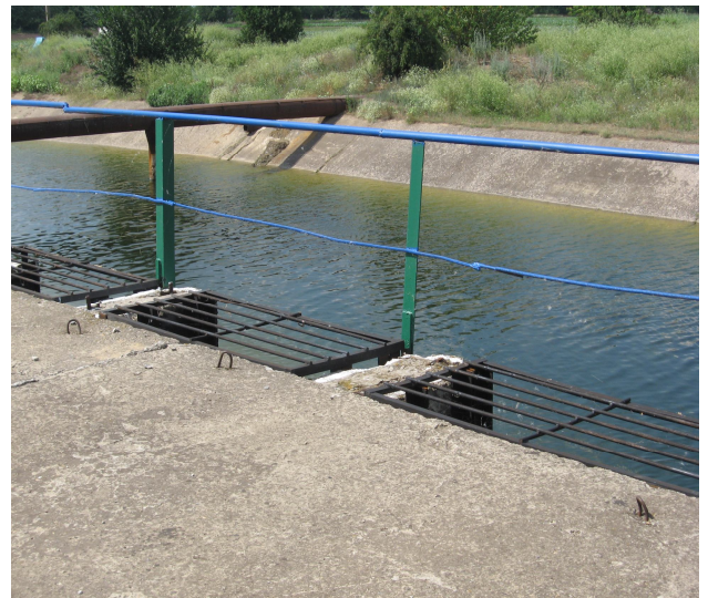
Фото: Водозабірна споруда НС № 11
