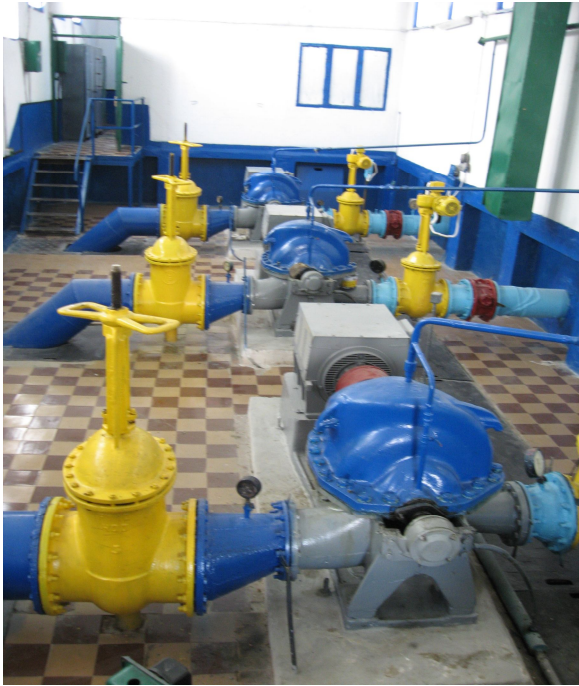
Фото: Машинний зал НС № 11
