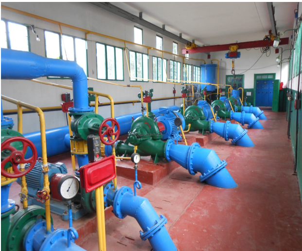
Фото: Машинний зал НСП № 12
