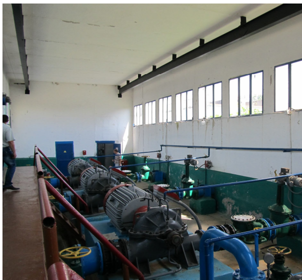
Фото: Машинний зал НС № 4 каналу 3 МК
